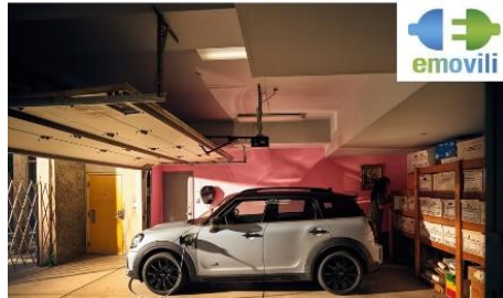
Instalación para wallbox. (sólo instalación) Vivienda Unifamiliar(7,4kW) 1.220€
